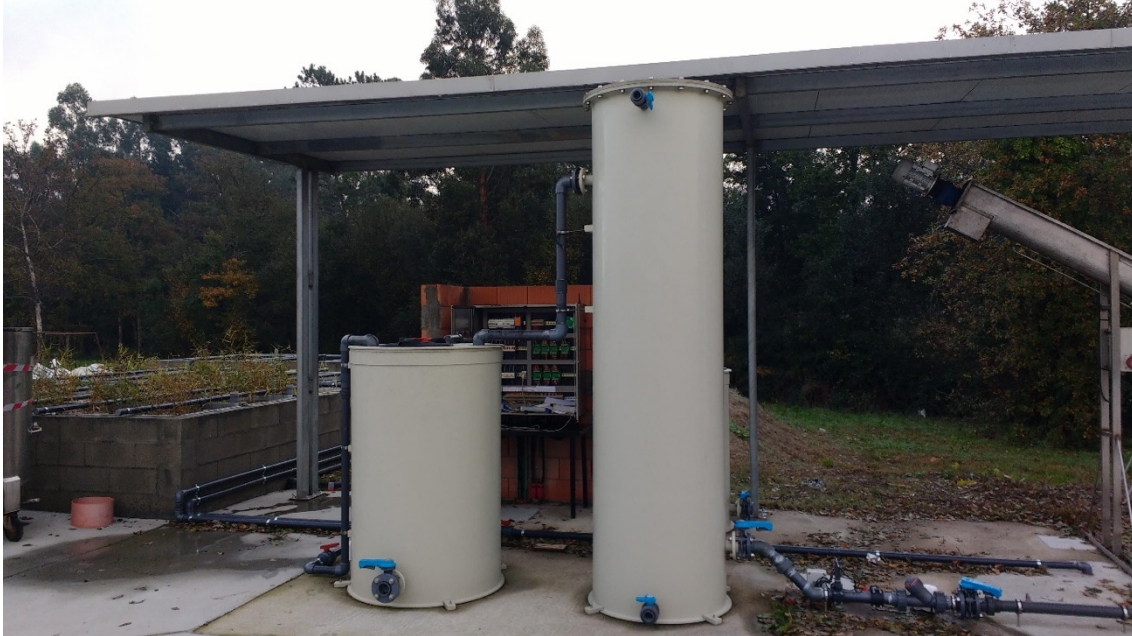
Sistema control, HUSB, tanque de lodos y humedales verticales de la planta piloto UVATEC.
